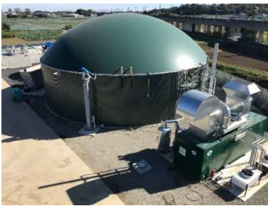
写真1：バイオガス発電施設と発酵タンク
