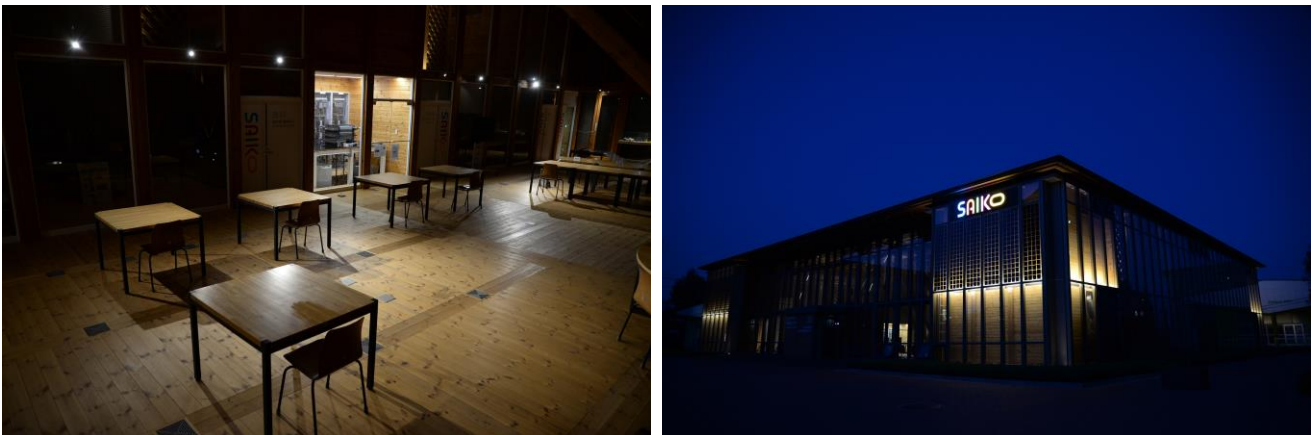
写真：レドックスフロー電池からの給電による実証実験の様子。 左：館内照明、右：外部間接照明
